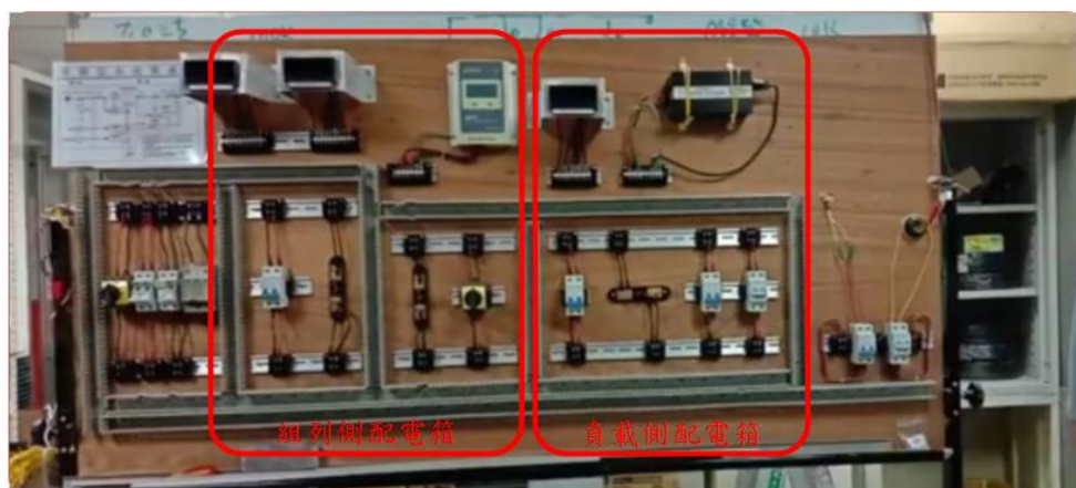
圖四 劉雅榛業師自製之獨立型配電盤。
